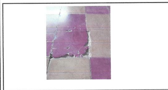
Foto 5: Piso en mal estado.
