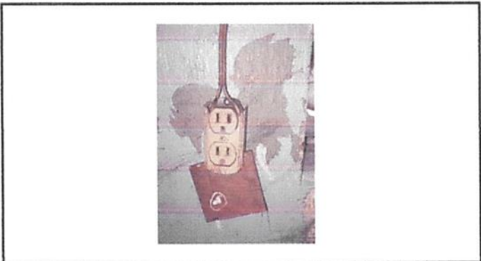
Foto 1: Instalación eléctrica de dos aulas, Dirección de INED, bodega de alimentos y bodega de Mecánica, en mal estado.
