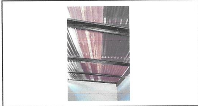
Foto 4: Lámina en mal estado.
